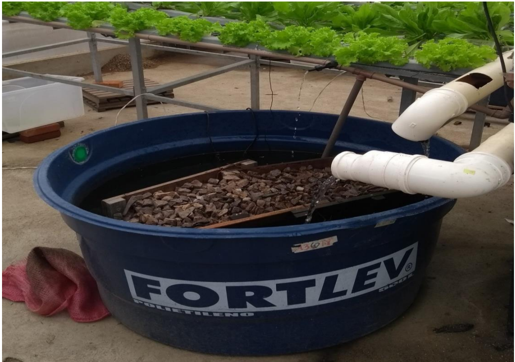
Figura 2 - Reservatório de água com filtro biológico para nitrificação da amônia
